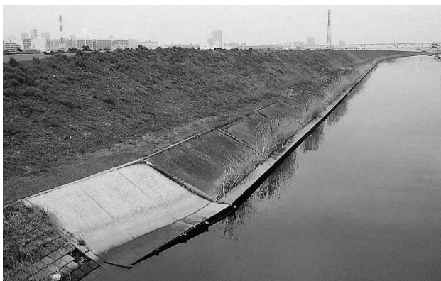
綾瀬川の法面 主にここでゴミを拾う
