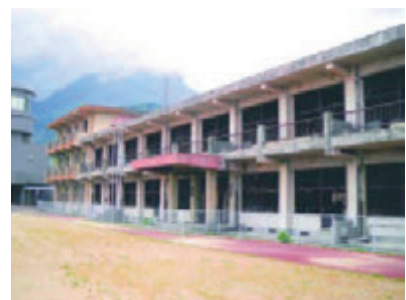
写真-25：小学校の被災遺構
