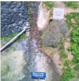
写真-37：断層破碎帯
