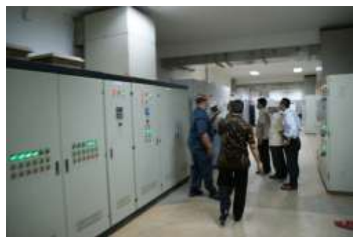
写真 4-39 メイン制御室
