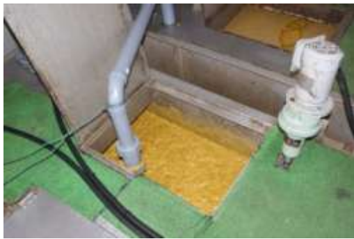
写真 5-38 循環槽で攪拌される液肥原料
