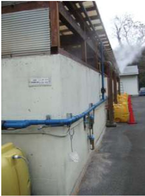
写真 5-13 脱臭システム施設
