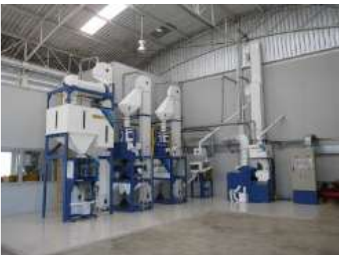
写真 4-3 ガス化発電施設
