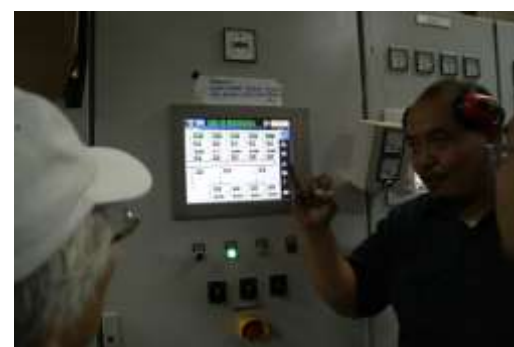
写真 4-41 各発電機毎の発電量のパネル
