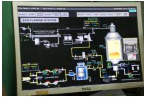
写真 4-50 制御室のコントロールパネル
