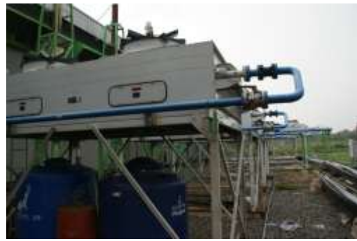
写真 4-37 メタンガス脱湿、圧縮装置
