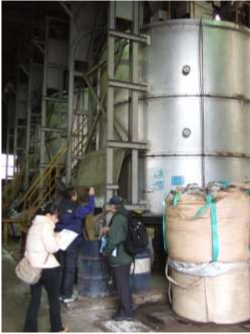
写真 5-8 コンポスト発酵槽
