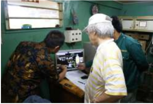
写真 4-49 フレア焼却施設制御室
