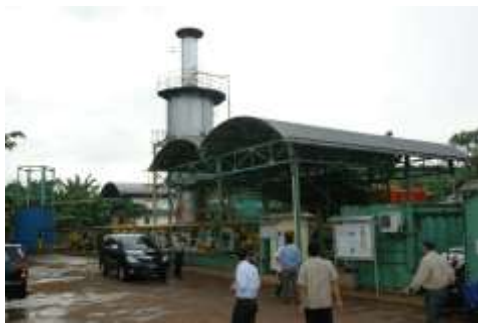
写真 4-47 メタンガスフレア焼却施設
