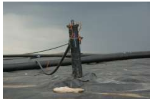
写真 4-35 ガス回収のためのガス井戸
