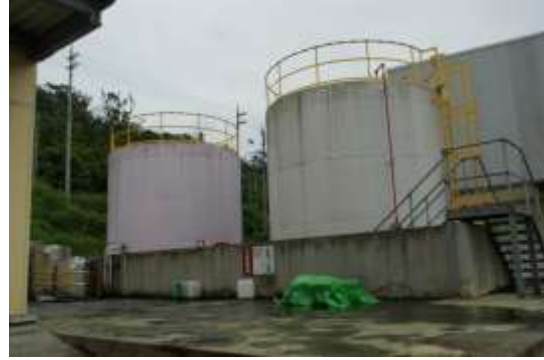
写真 3-6 灯油・廃食用油貯留槽
