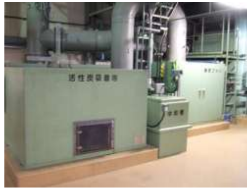
写真 5-30 活性炭吸着塔
