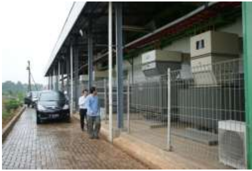
写真 4-36 メタンガス発電施設入口
